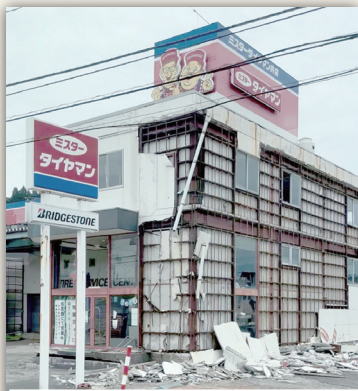
外壁が剥がれ落ちたままの事業所
